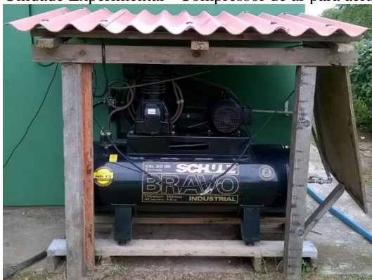
Figura 12 - Unidade Experimental - Compressor de ar para aeração do BRM
