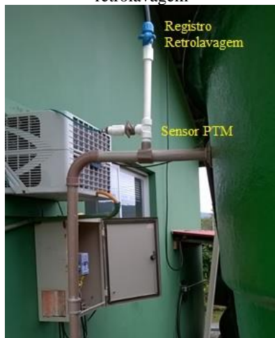
Figura 15 - Unidade Experimental - Detalhe sensor PTM e Registro para retrolavagem
