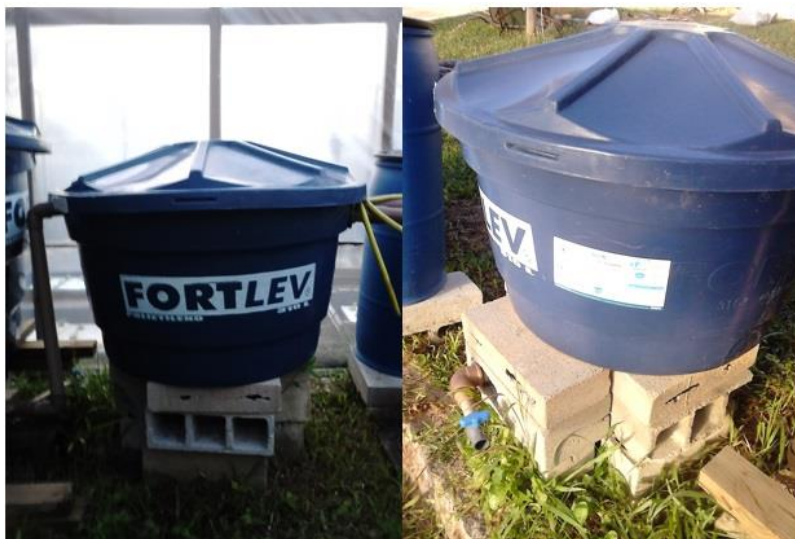
Figura 15 – Detalhe do decantador e do registro para remoção dos sólidos
