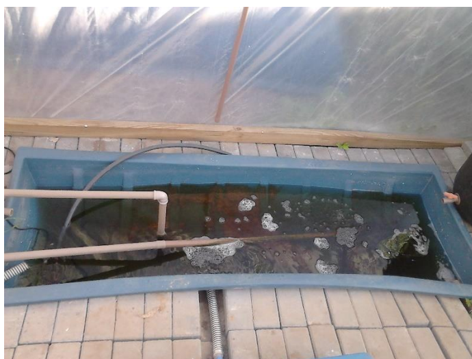
Figura 18 – Tanque de equalização
