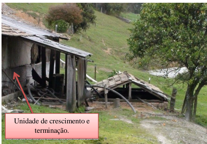
Figura 10: Tanque de passagem localizado em APP, rodeado de “entulhos”.
