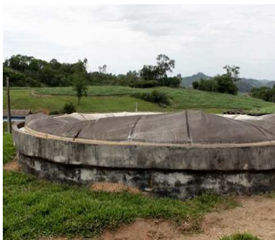
Figura 3: Situação atual do Biodigestor.
