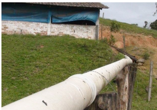
Figura 7: Tubulação que, segundo Laudo Técnico, apresentava vazamento de efluentes.
