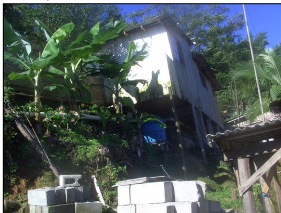
Figura 72: Casa em situação de vulnerabilidade. Bairro Prado.
