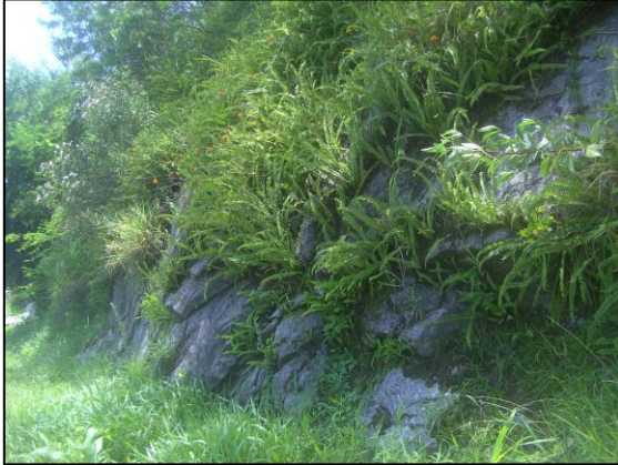
Figura 45: Camadas de rochas foliadas concordantes com a declividade da encosta em talude de corte. Bairro São Miguel.
