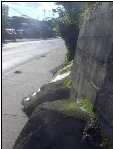
Figura 70: Muro sobre matacões na base da encosta. Rua 13 de Maio. Bairro Prado.
