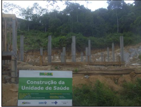
Figura 49: Corte na base da colina. Acima, vegetação secundária em estágio inicial de regeneração. Bairro Prado, local de construção do posto de saúde.
