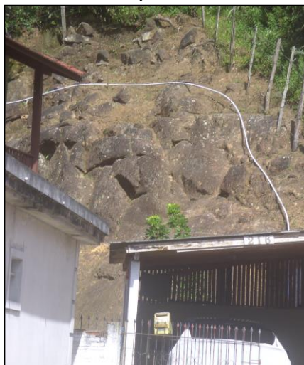
Figura 44: Corte na base da encosta expondo afloramento de rocha granítica, na parte superior do corte alteração mais avançada em linhas de fraqueza da rocha destacando blocos, sobre solo pouco desenvolvido. Bairro Prado.
