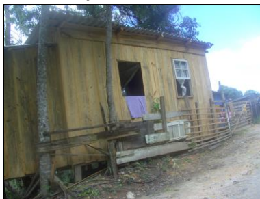
Figuras 66: Padrão de construção vulnerável. Bairro Prado.
