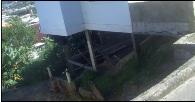
Figura 63: Exemplo de padrão construtivo, alicerce sobre pilares. Observar a estrutura que sustenta a casa e a declividade do terreno. Bairro Prado.
