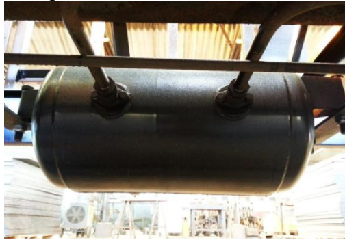
Figura 23 – Reservatório de ar
