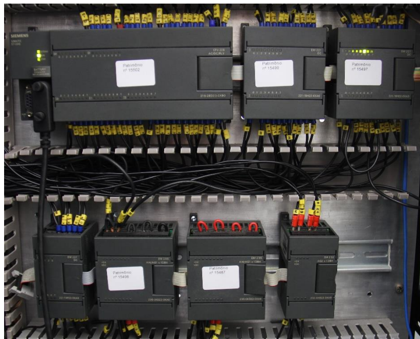
Figura 12 – CLP Siemens S7-200 CPU 226 e módulos EM221 com 16 saídas (x2), EM221 com 8 saídas, EM235 (x2) e EM232 atrás do RAM.
