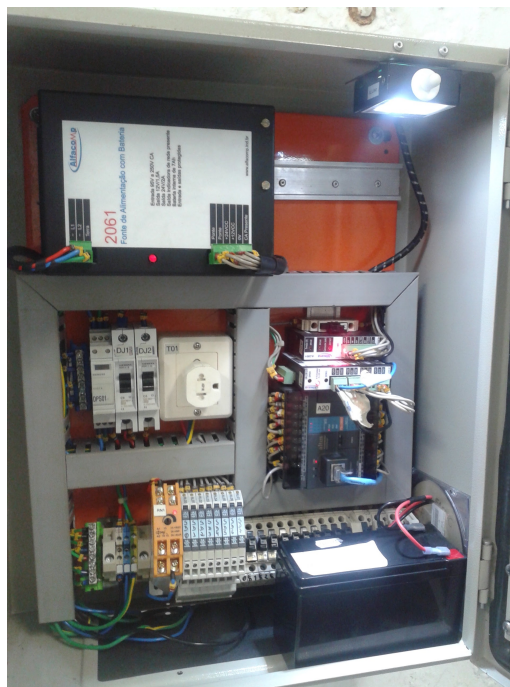
Figura 58 – Quadro de Telemetria em São José
