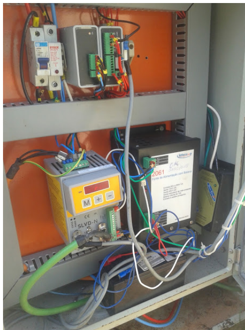
Figura 67 – Quadro de telemetria na ETA Morro dos Quadros
