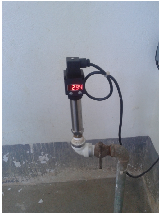
Figura 60 – Transmissor de pressão no reservatório R1
