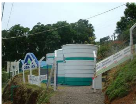
Figura 6 – ETA Xavantina (fonte: CASAN).
