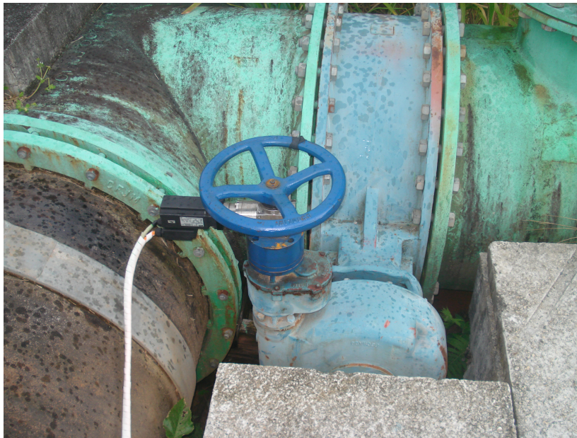
Figura 63 – Válvula Borboleta bi-excêntrica na adutora de 1200mm
