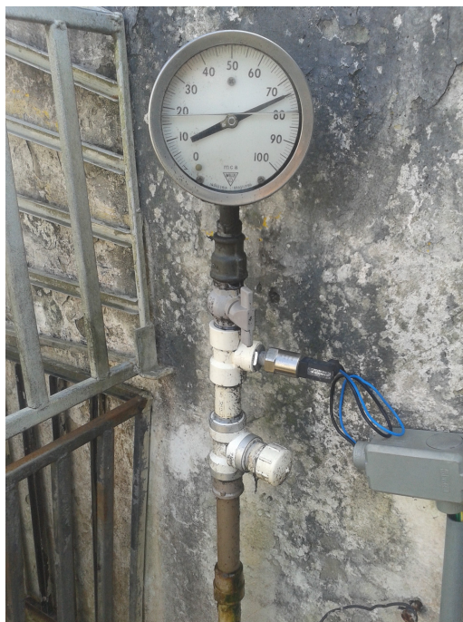
Figura 59 – Manómetro e transmissor de pressão
