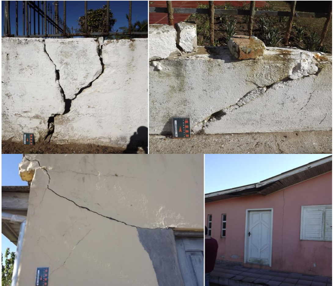
Figura 33. Rachaduras nas casas do bairro Hercílio Luz em Araranguá.
