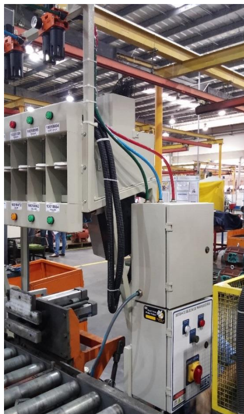
Figura 50 - Vista lateral do sistema e dos painéis
