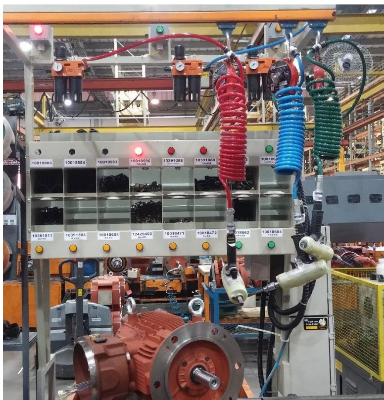
Figura 51 – Vista frontal do sistema instalado na Fábrica VI
