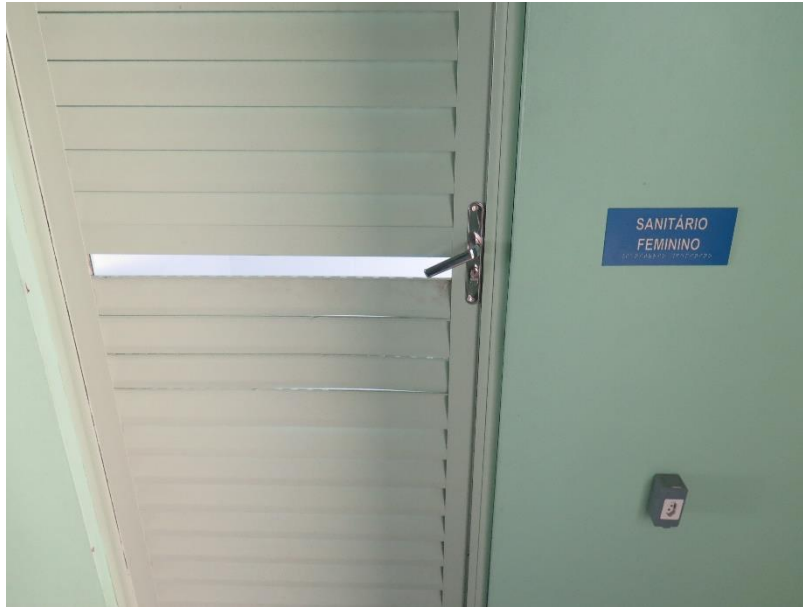
Figura 68 - Porta do banheiro quebrada
