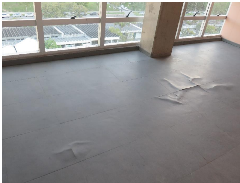
Figura 57 - Placas de borracha enrugadas na área de circulação do 5º andar
