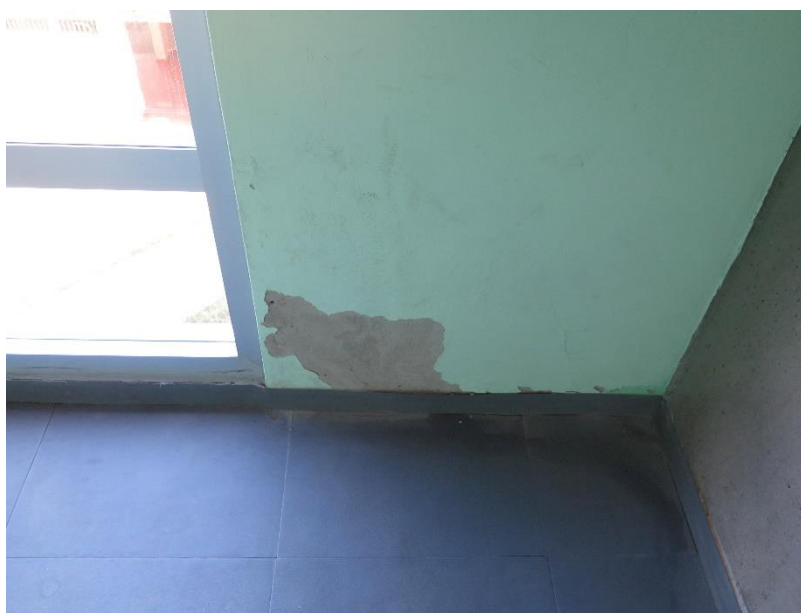
Figura 67 - Parede com tinta descascada
