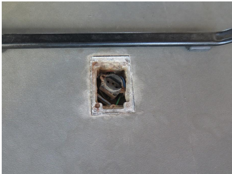
Figura 71 - Tomada sem tampa de proteção
