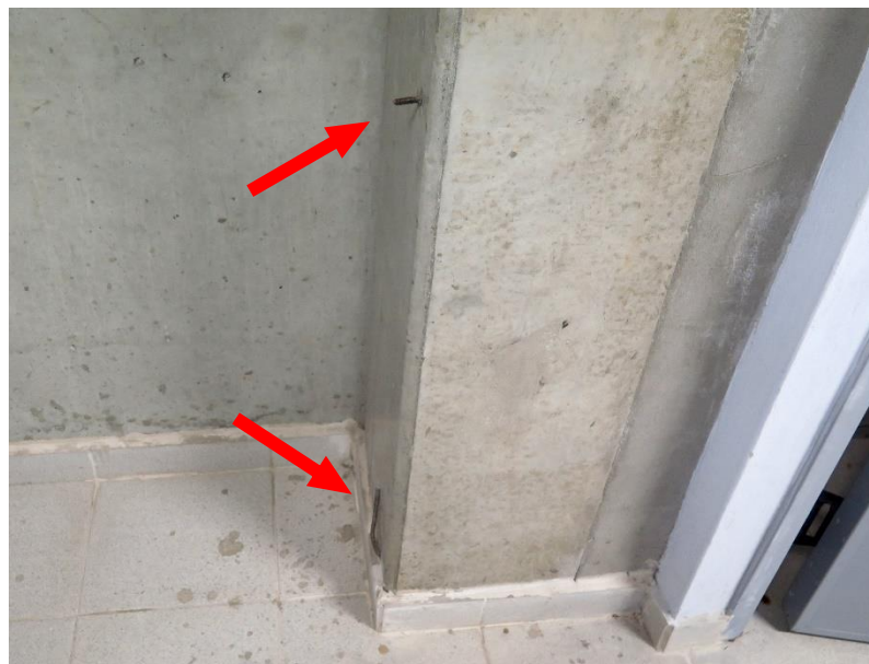
Figura 61 - alça de içamento exposta
