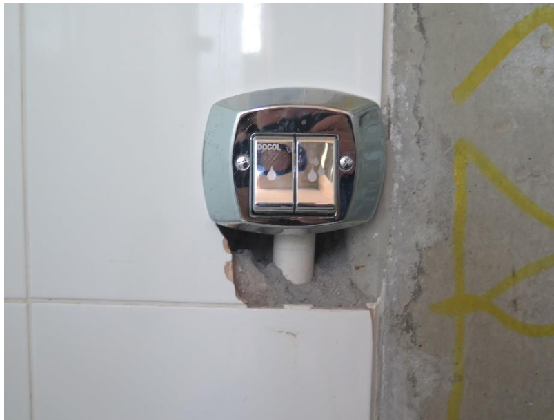
Figura 69 - Azulejo e reboco quebrados
