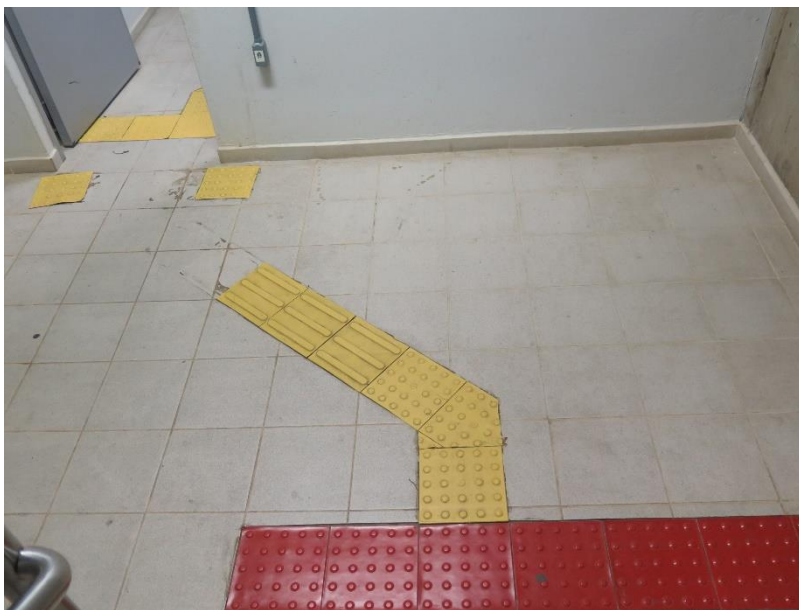
Figura 72 - Falta do piso para deficientes visuais
