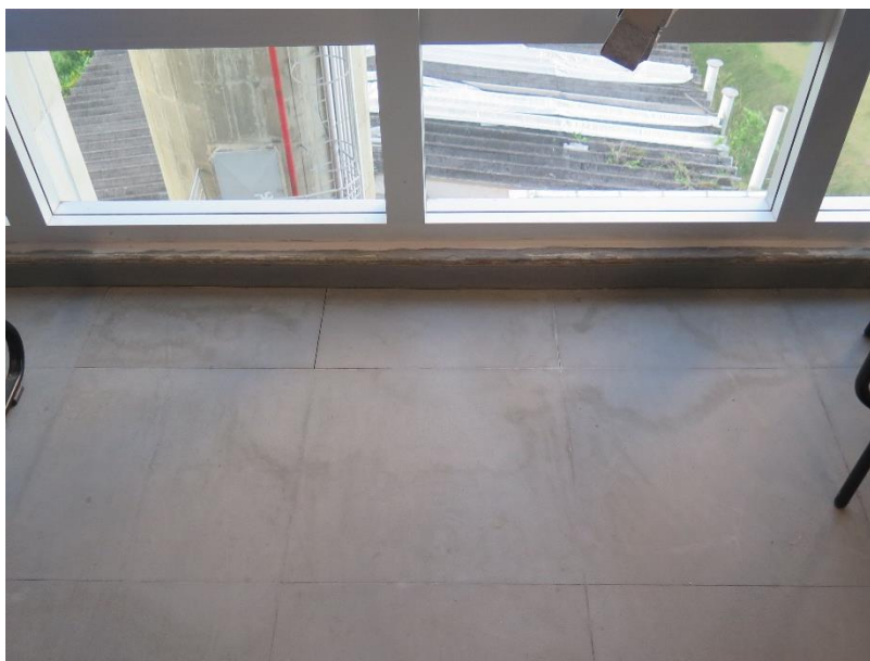
Figura 54 - Mancha nos pisos próximos às janelas na sala 304
