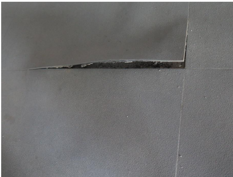
Figura 56 - Piso parcialmente descolado na sala 501
