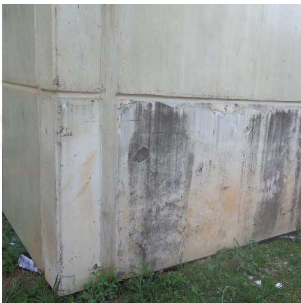
Figura 43 - Disparidade nas espessuras das juntas entre painéis
