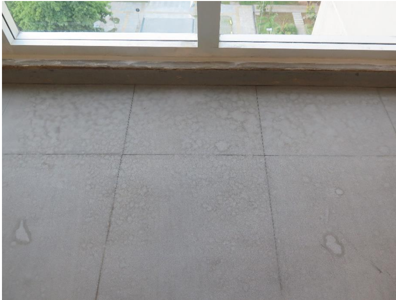
Figura 55 - Mancha nos pisos próximos às janelas na sala 501
