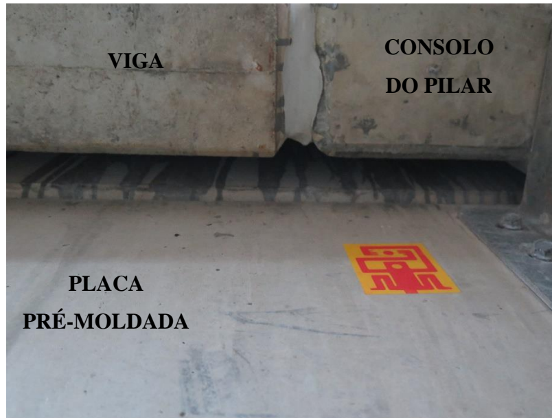
Figura 47 - Infiltração ocorrida pela junta entre as placas pré-moldadas
