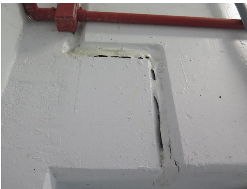
Figura 49 - Aplicação incorreta do mastique na ligação entre viga e pilar
