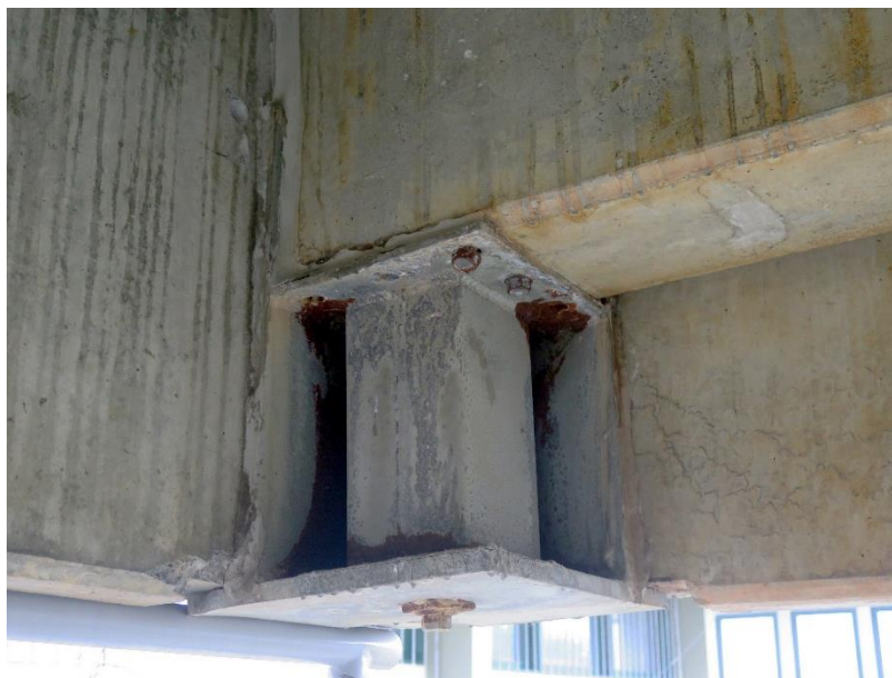
Figura 59 - Dispositivo metálico corroído - fixação das placas de canto
