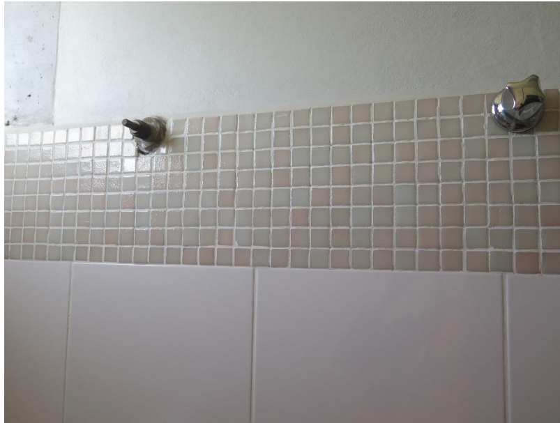
Figura 70 - Falta da torneira em banheiro
