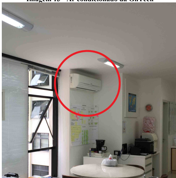
Imagem 13 - Ar condicionado da GnTech
