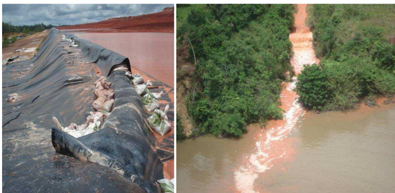
Figura 7: Detalhes do local de transbordo da bacia de rejeito, fato que foi negado pelos funcionários da ALUNORTE (Barcarena, PA).
