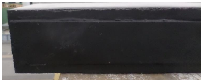
Figura 6.25 – Imagem fotográfica da viga PCR, lado esquerdo, na qual não se visualiza a delaminação a olho nu.
