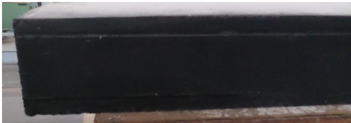
Figura 6.26 – Imagem fotográfica da viga PVR, lado esquerdo, na qual não se visualiza a delaminação a olho nu.
