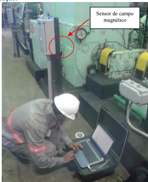
Figura 66 - Medição do campo magnético externo no motor de uma bomba d'água em operação.
