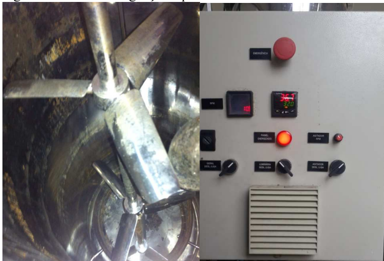
Figura 9 - Sistema de agitação e painel de controle.
