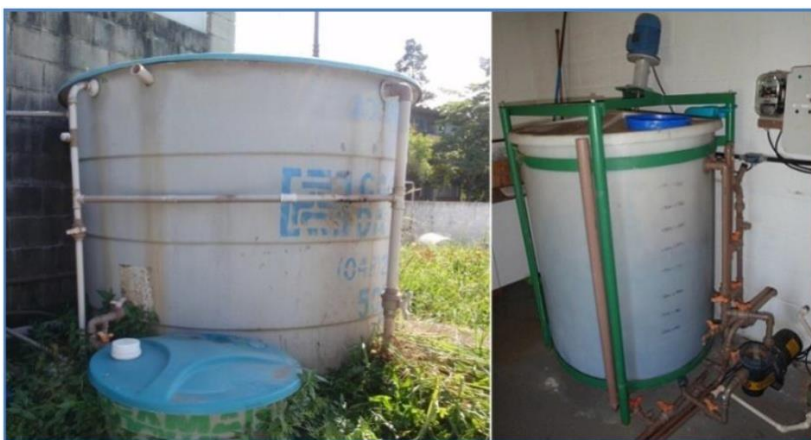
Figura 6. Na esquerda o tanque de armazenamento e à direita o tanque de armazenamento com misturador. Fonte: Daudt, 2015.
