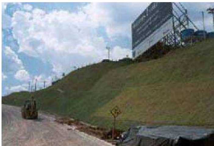
Figura 38 - Talude em acesso a condomínio Vila Amalfi em São Paulo
