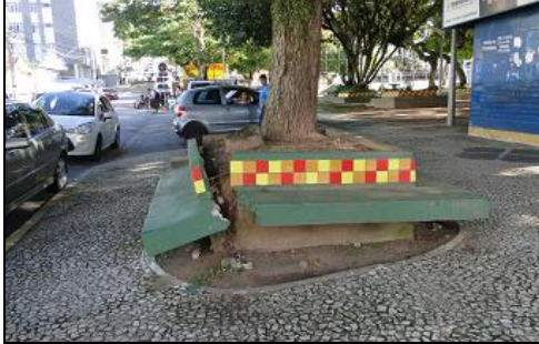
Figura 26 - Banco de concreto quebrado.
