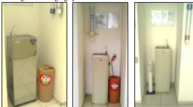
Figura 17. Segregação nos bebedouros dos blocos A e B.
