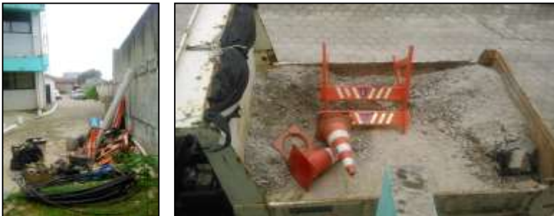
Figura 21. Resíduos do serviço de manutenção externa - Restos de tubos e entulhos de escavação
