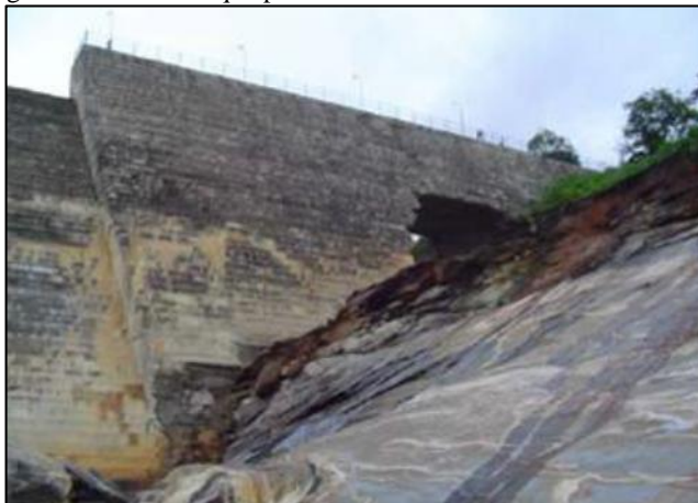
Figura 3.5 - Orifício que provocou o esvaziamento do reservatório.
