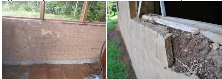
Figura 85 – Aparência dos defeitos de rebocos sobre construções com terra.
