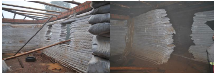
Figura 84 - Consequência de paredes longas sem reforço
