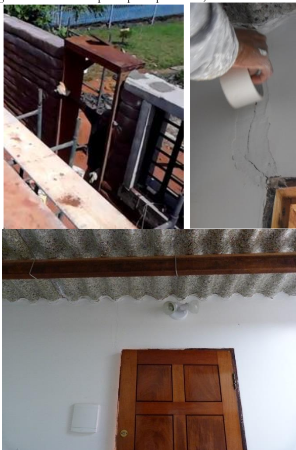
Figura 132 Fissura da porta principal: causa, conserto e resultado.
