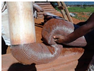
Figura 134 - Defeito no preenchimento da sacaria.
