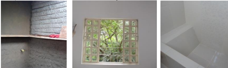
Figura 114 - Acabamento convencional: reboco e chapisco em cima da prateleira, emboço embaixo; massa corrida e tinta epóxi na sala; revest. cerâm. no banheiro.
