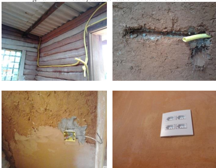
Figura 113 - Instalações elétricas embutidas no reboco.
