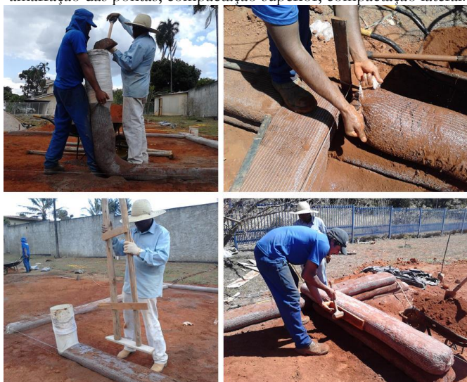
Figura 105 - Processo construtivo em terra ensacada: preenchimento da sacaria, amarração das pontas, compactação superior, compactação lateral.
