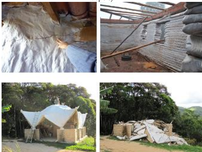
Figura 6 - Problemas registrados em construções de terra: rachaduras no reboco; deformações acentuadas e instabilidade estrutural; colapso da estrutura (antes e depois).
