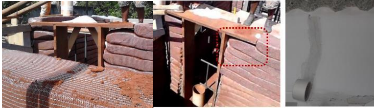
Figura 133 Fissura da porta do dormitório: causa e conserto.
