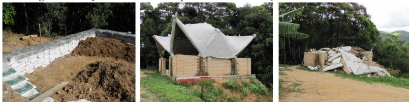
Figura 86 - Queda da estrutura por falha na fundação em terra ensacada.
