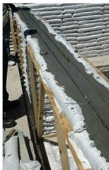
Figura 79 - Cinta de amarração de concreto armado entre os vãos da sacaria costurada.
