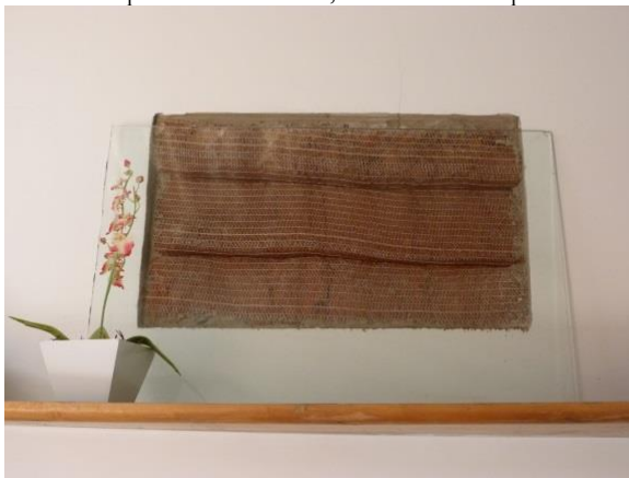
Figura 115 - Área da parede sem reboco, testemunho do processo construtivo.
