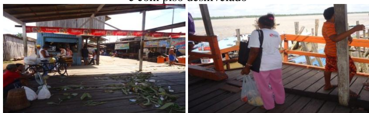
Figura 182. Área coberta do Porto apresenta-se como um espaço desorganizado e com piso desnivelado
