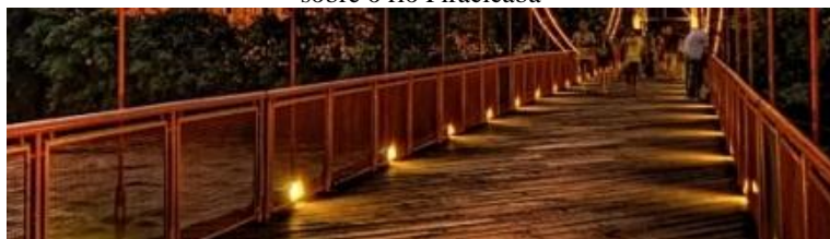
Figura 100- Guarda- corpo com estrutura e fechamento de metal. Ponte Pênsil sobre o rio Piracicaba
