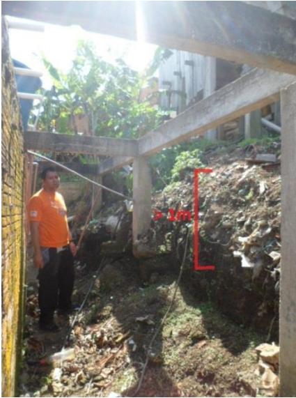
Figura 44 – Talude de aterro composto por entulho e lixo.
