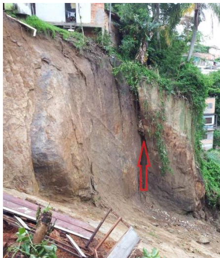
Figura 22 – Lixo preenchendo fratura.
