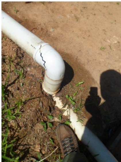
Figura 12 - Tubulação particular danificada.
