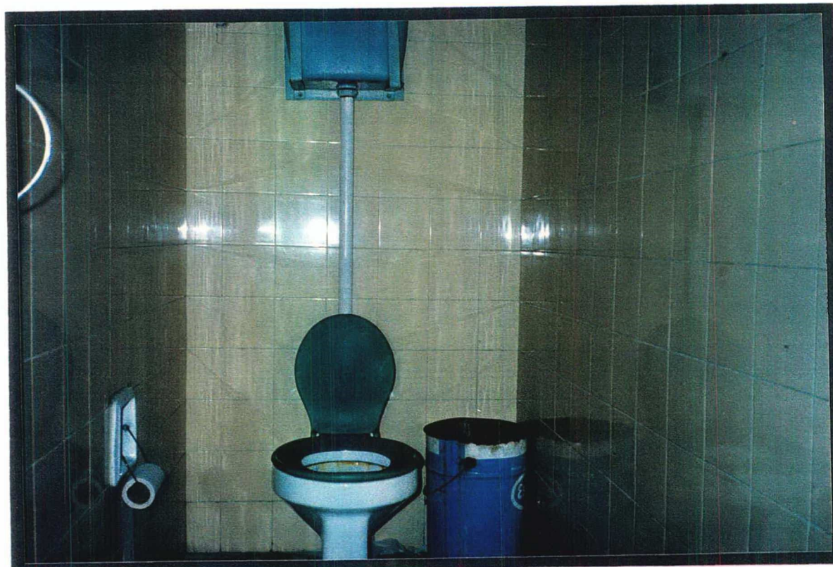
Figura 20 — Fotografia do banheiro da oficina de manutenção (05/95)
