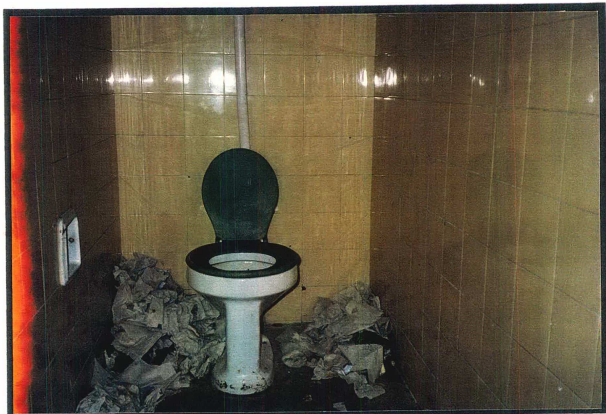
Figura 19 — Fotografia do banheiro da oficina de manutenção (01/95)
