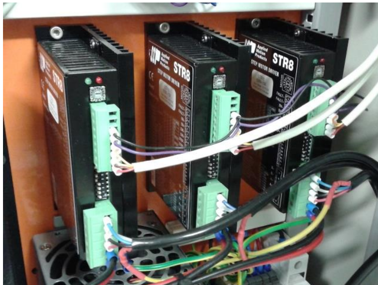
Figura 17 – Driver STR8 instalado no equipamento.
