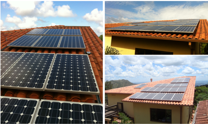
Figura 3.7 - BHO-1: SFVR residencial em Belo Horizonte - MG.
