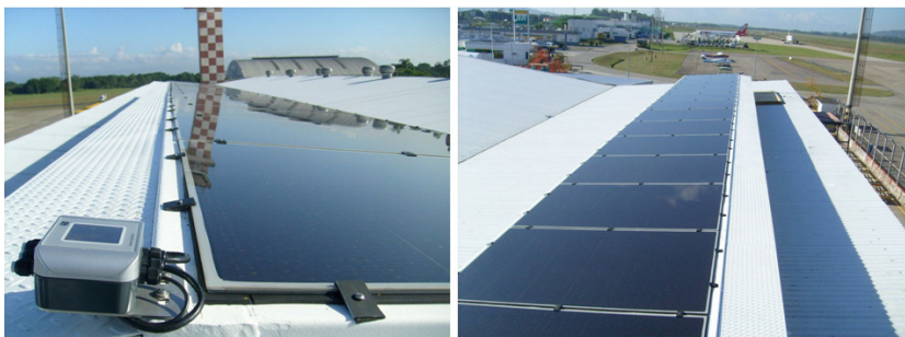
Figura 3.4 - SFVCR FLN-3: integrado à cobertura do prédio de cargas da INFRAERO no aeroporto de Florianópolis.
