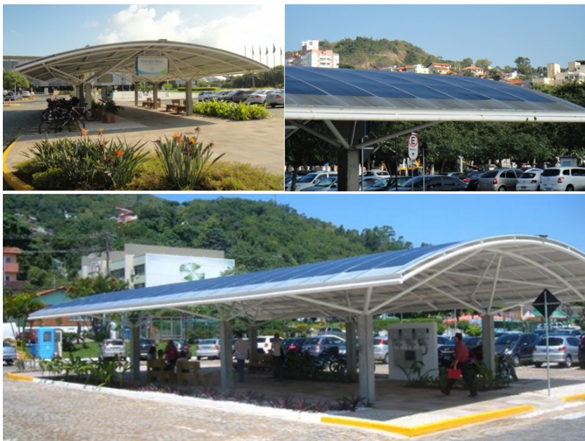
Figura 3.6 - SFVCR FLN-4: planta piloto do Projeto MegaWatt Solar.
