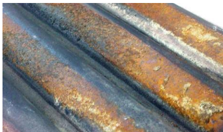
Figura 1.1. Região afetada por erosão e corrosão
