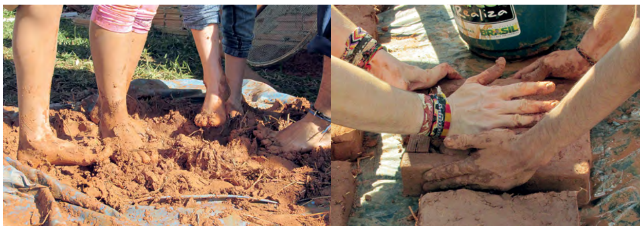
Utilização da técnica de adobe (terra crua) para produzir 16 blocos que serão utilizados na construção da base para o forno de pizza.
