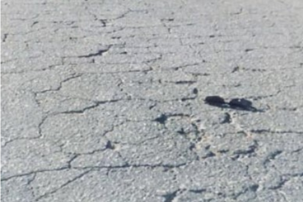
Figura 2.19 - Trincamento devido à fadiga do revestimento.
