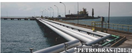
Dutos transportadores de combustíveis Terminal Marítimo Almirante Barroso (São Sebastião-SP)
