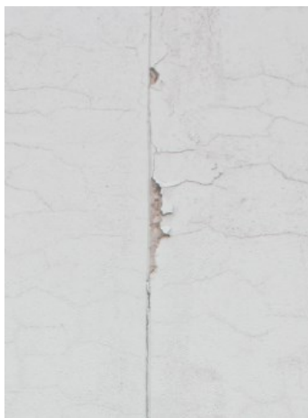
Figura 23 - Deslocamento do reboco rente à junta de dilatação
