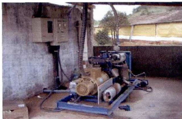
Figura 22: Exemplar similar ao motor gerador de 50 kVA instalado na Granja Fonte: Oliveira, 2008.
