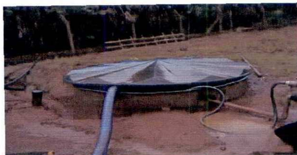
Figura 14: Tanque de homogeneização Fonte: Arquivo do autor
