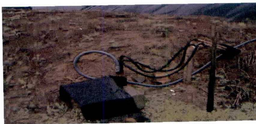
Figura 17: Compressor para movimentação do biogás Fonte: Arquivo do autor
