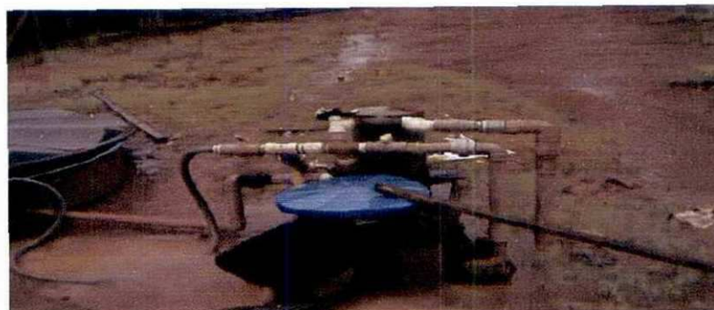
Figura 15: Bomba do tanque de homogeneização Fonte: Arquivo do autor
