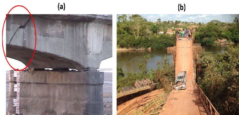
Figura 1.2: (a) Trinca no vão da ponte em estado avançado, comprometendo a segurança da estrutura, (b) Colapso da ponte na rodovia BR-230 no estado do Pará, provocada por danos resultantes da falta de manutenção (fonte: Diário online).
