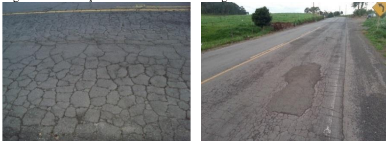
Figura 73: Condições do revestimento no segmento 3
