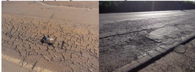
Figura 71: Principais patologias encontradas no segmento 1
