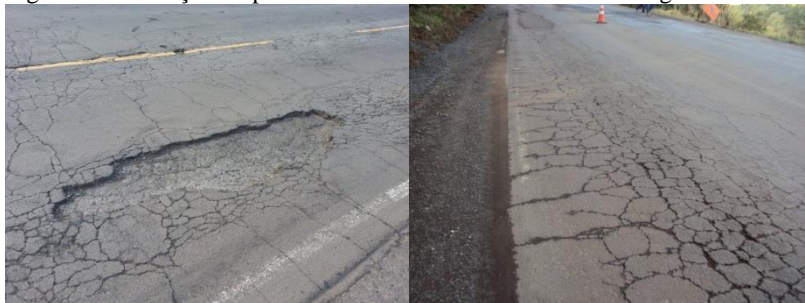
Figura 72: Condições superficiais da camada de rolamento do segmento 2
