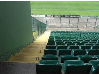
Figura 78 – Ponto cego no setor A
