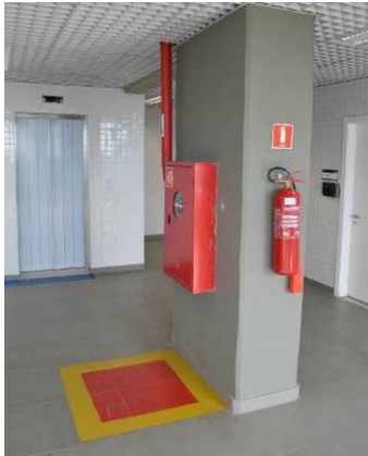
Figura 13 – Exemplos de proteções ativas (hidrante e extintor)
