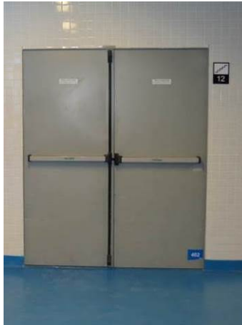
Figura 12 – Exemplo de proteção passiva
