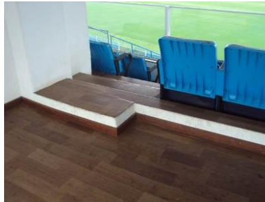
Figura 59 – Desnível no corredor
