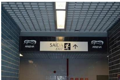
Figura 101 – Placas de sinalização
