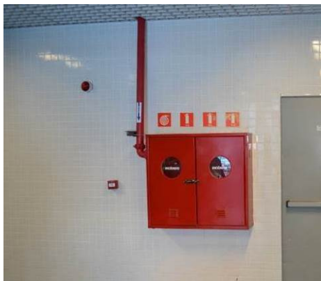
Figura 91 – Hidrantes e botoeiras de alarme
