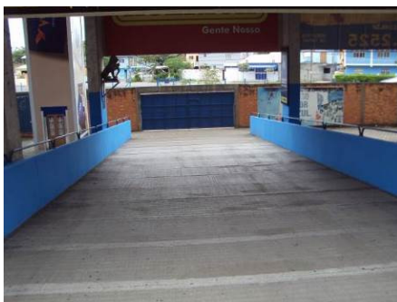
Figura 63 – Falta de corrimão nas rampas
