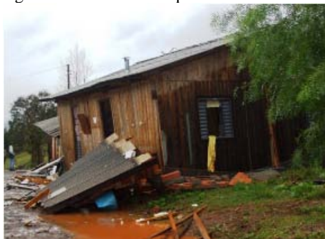
Figuras 12 e 13 – Casas que foram inundadas.
