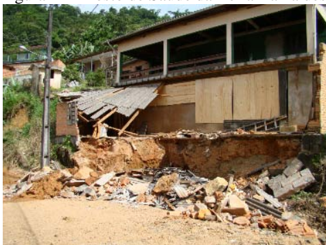
Figura 11 – Posto de Saúde da Beira Baixa destruído pela inundação.
