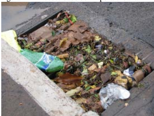
Figura 24 – Necessidade de limpeza urbana.
