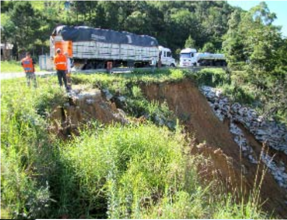
Figuras 21 e 22 – Rodovia estadual com 3 km de estrada destruída.
