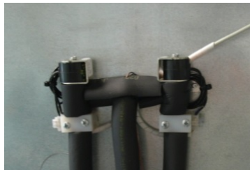
Figura 16 – Válvulas de expansão.
