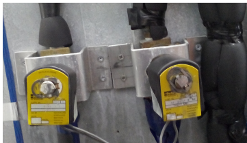
Figura 17 – Válvulas de distribuição.
