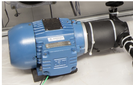
Figura 6 – Motor elétrico e bomba de engrenagens responsável pela circulação da mistura
