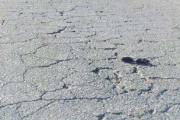
Figura 2.19 - Trincamento devido à fadiga do revestimento.
