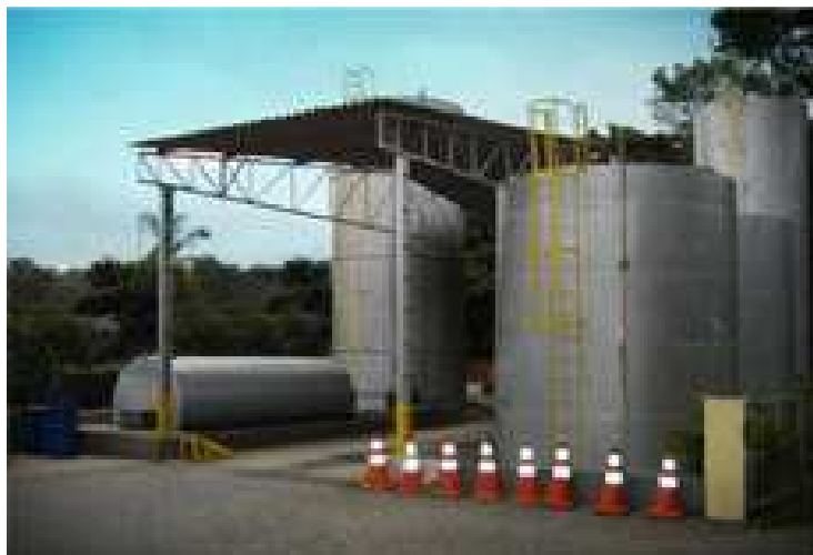
Figura 7 - Tanques de armazenagem do óleo lubrificante usado ou contaminado
