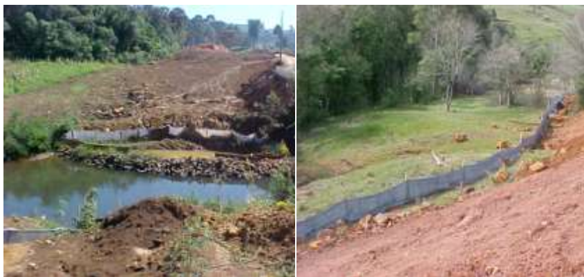
Figura 36 e Figura 37 – Exemplos de adoção de barreira de siltagem para contenção de sedimentos finos.
