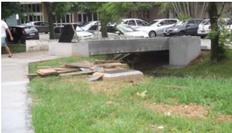
Figura 5. 11. Ponto irregular de depósito de resíduos.
