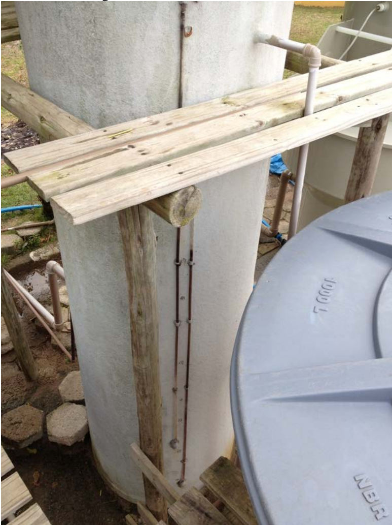
Figura 15 – Piezômetro instalado no FLR
