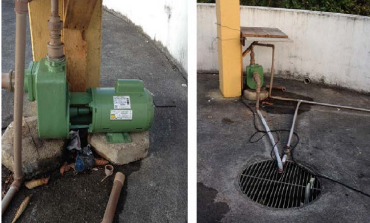
Figura 6 - Bomba e Poço de captação
