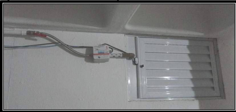
Figura 22 - Válvula solenóide e componentes (obra)
