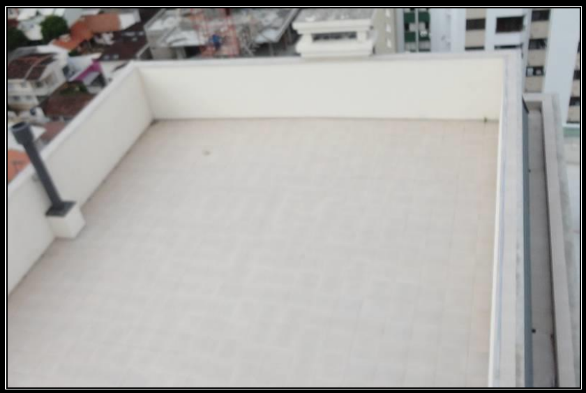
Figura 37 – Calha para condução de água da chuva
