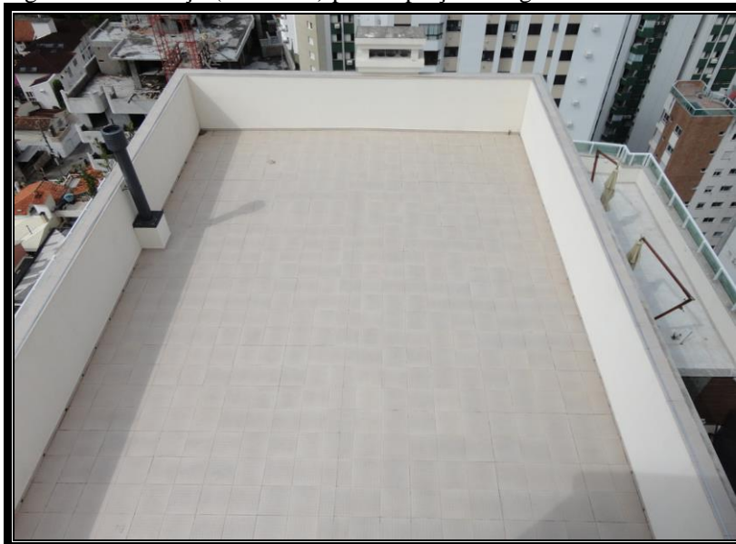
Figura 35 – Terraço (cobertura) para captação de água da chuva
