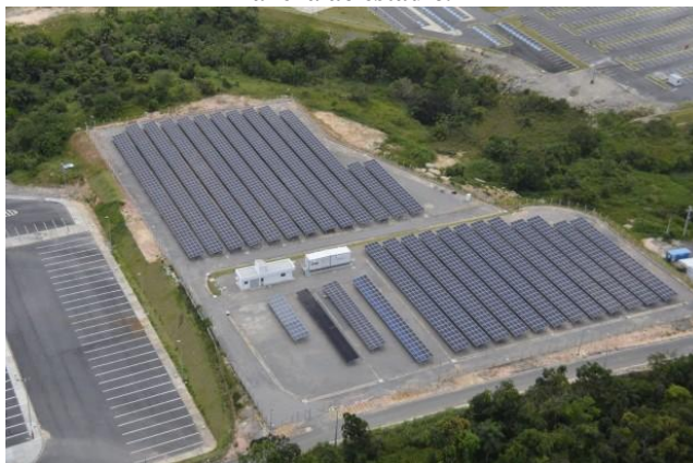
Figura 7. Painéis fotovoltaicos na Usina Solar de São Lourenço da Mata, anexa ao estádio.
