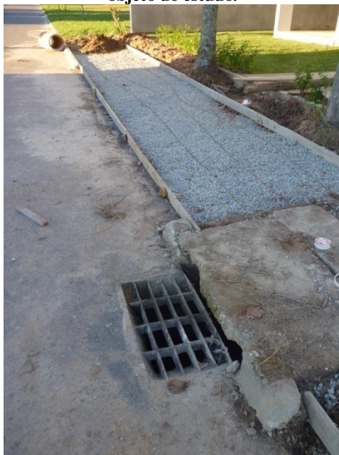
Figura 21. Boca de lobo localizada próximo à esquina. Em frente à obra objeto do estudo.
