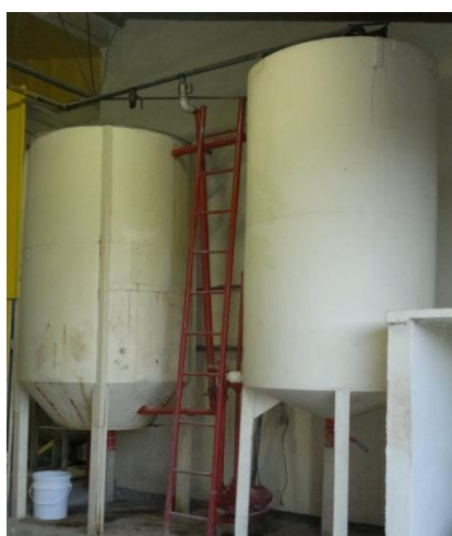
Figura 15. Tanque de Armazenamento de óleo de Frango. Fonte: Registro fotográfico do autor, 2014.
