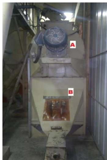
Figura 11. Misturador Horizontal (A) e Silo Pulmão (B). Fonte: Registro fotográfico do autor, 2014.
