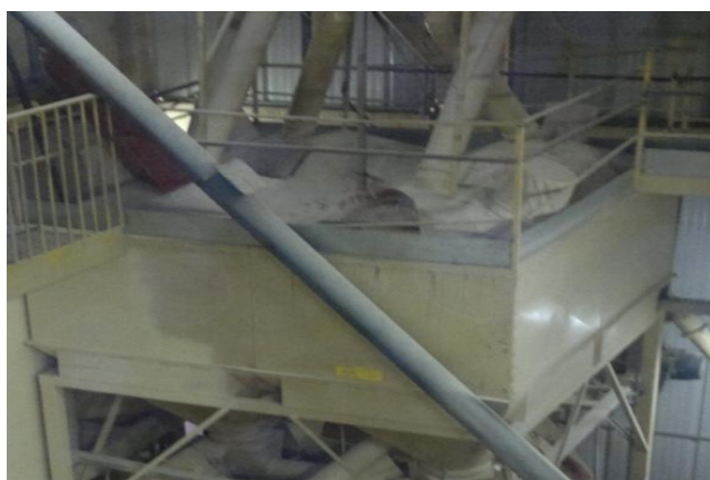
Figura 9. Silo de Dosagem de Macro ingredientes. Fonte: Registro fotográfico do autor, 2014.
