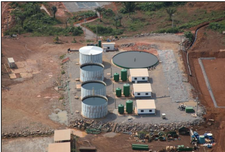
Figura 3:ETAs de 20m 3 /h (potável) e 300m 3 /h (industrial)
