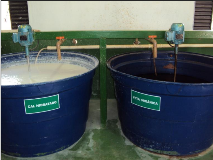
Figura 4: Tanques dos reagentes - Casa de química ETA 20m 3 /h
