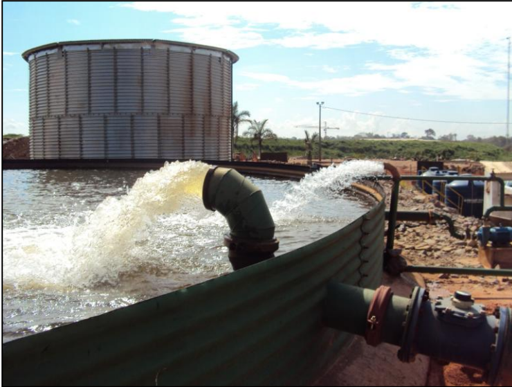
Figura 8: Tanque de água bruta. Em primeiro plano, entrada de água bruta. Em segundo, entrada de água reaproveitada
