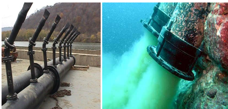
Figura 7 - Difusores ( risers ) de emissários submarinos. Fonte: TAVARES (2010).
