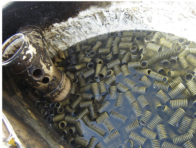
Figura 3: Filtro aerado submerso preenchido com eletrodutos de plástico.
