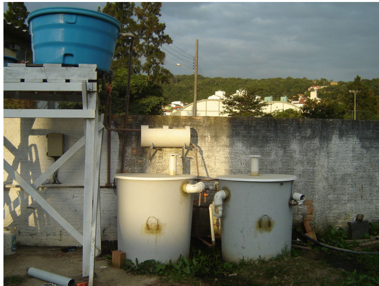
Figura 1: Sistema desenvolvido para o tratamento local de esgotos domésticos.
