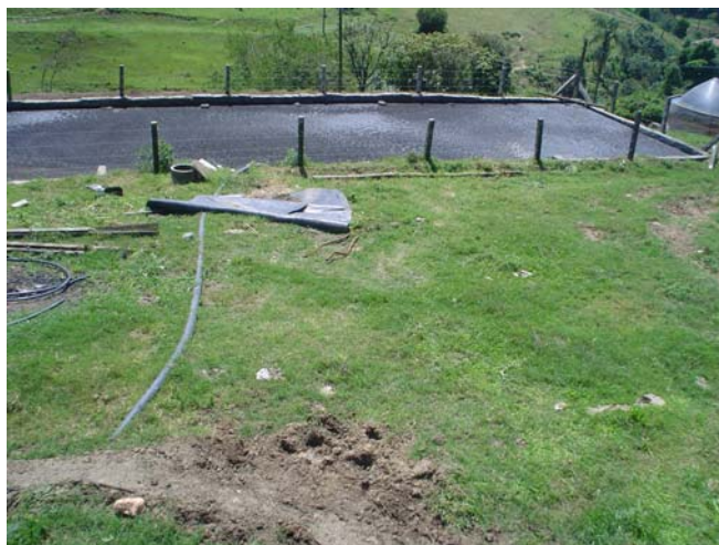
Figura 28 – Esta foto mostra que a esterqueira, da propriedade em estudo, que recebe o efluente do biodigestor não possui canaletas de drenagem da água pluvial. Fonte: Vamblê, outubro de 2007.
